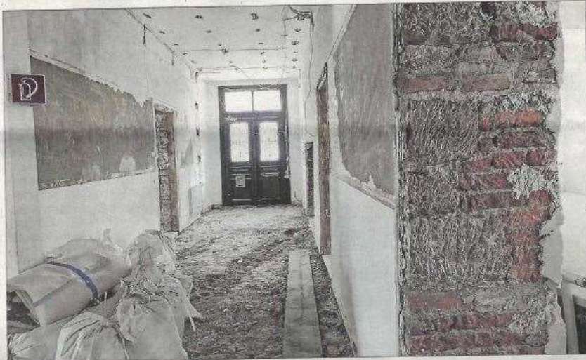
Noch ist der Flur im Eingangsbereich des ehemaligen Grundschulgebäudes im Rohbauzustand. Doch schon im kommenden Jahr soll er als Platz für die Bildungsangebote, der neuen Klaus-Grohe-Kindertagesstätte, integriert werden. Foto: Martina Baumgartner
